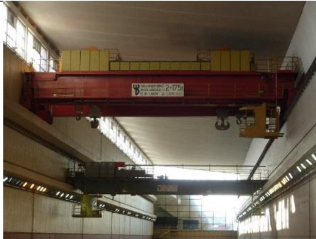
Fotografía 20: Grúa Puente 2x 175t y Grúa Puente 25t
