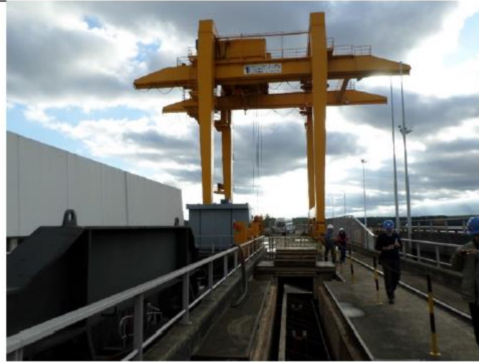
Fotografía 18: Grúa pórtico de toma
