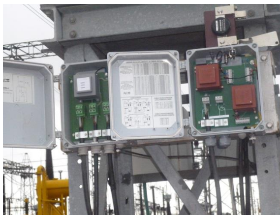
Fotografía 39: Filtros de acoplamiento e híbrido de acoplamiento
