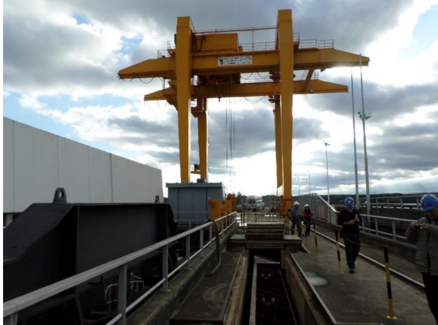
Fotografía 18: Grúa pórtico de toma
