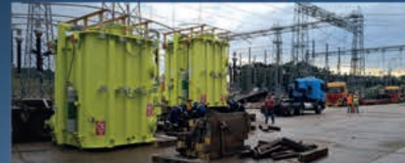
Adquisición de un banco de reactores Shunt
