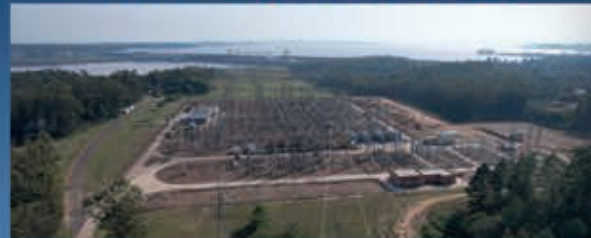
Ampliación de Subestación Salto Grande Uruguay
